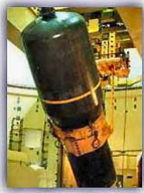
Gerador de Vapor
